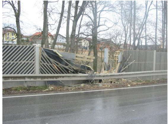
Umgefallener Baum zerstört Lärmschutzwand
